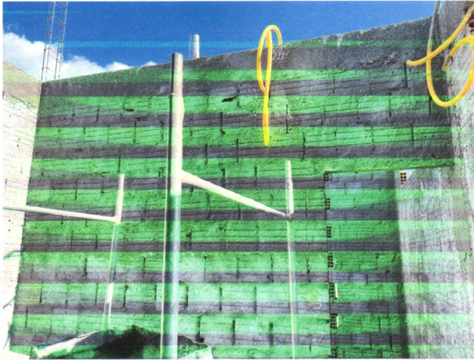
IMAGEM 09 - CHAPISCO APLICADO EM ALVENARIA (COM PRESENÇA DE VÃOS) E ESTRUTURAS DE CONCRETO DE FACHADA, COM COLHER DE PEDREIRO. ARGAMASSA TRAÇO 1:3 COM PREPARO EM BETONEIRA 400L. AF_06/2014
